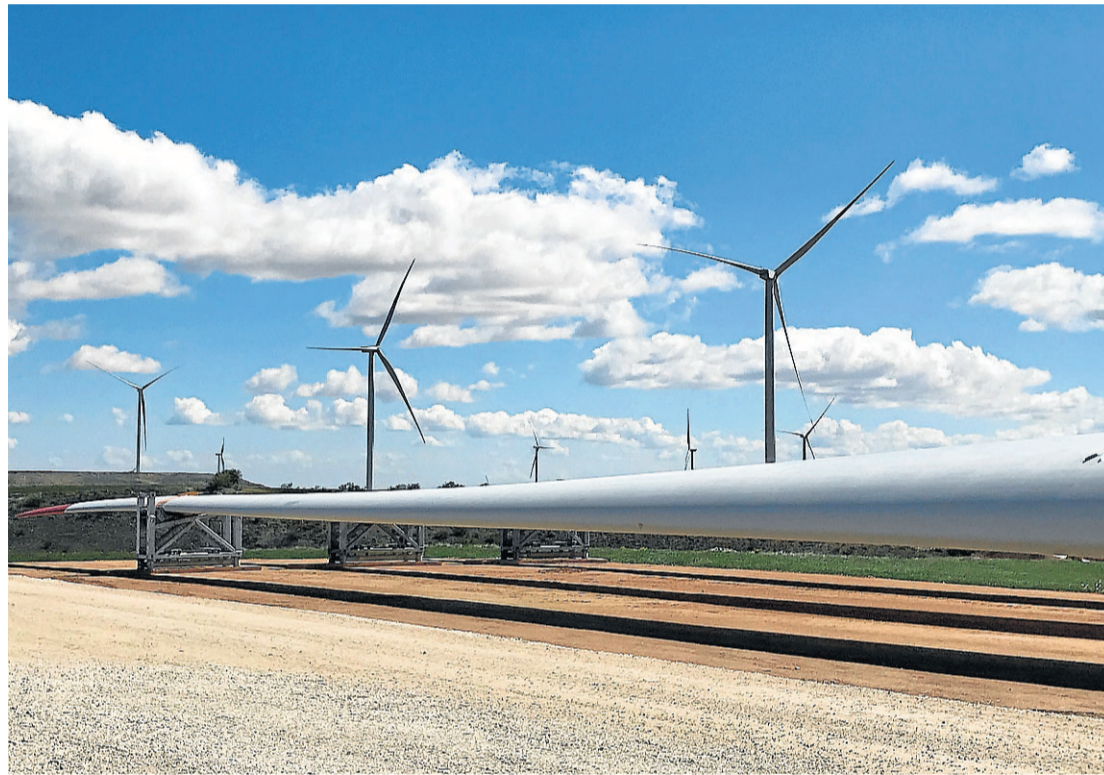
Construcción en el término municipal de Azuara de uno de los parques eólicos de Forestalia. HA
